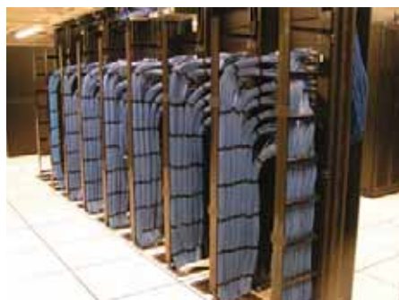
El ICKC se muestra instalado.
