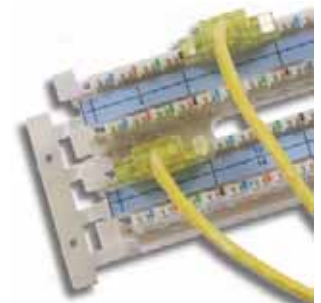
Bloques de interconexión
